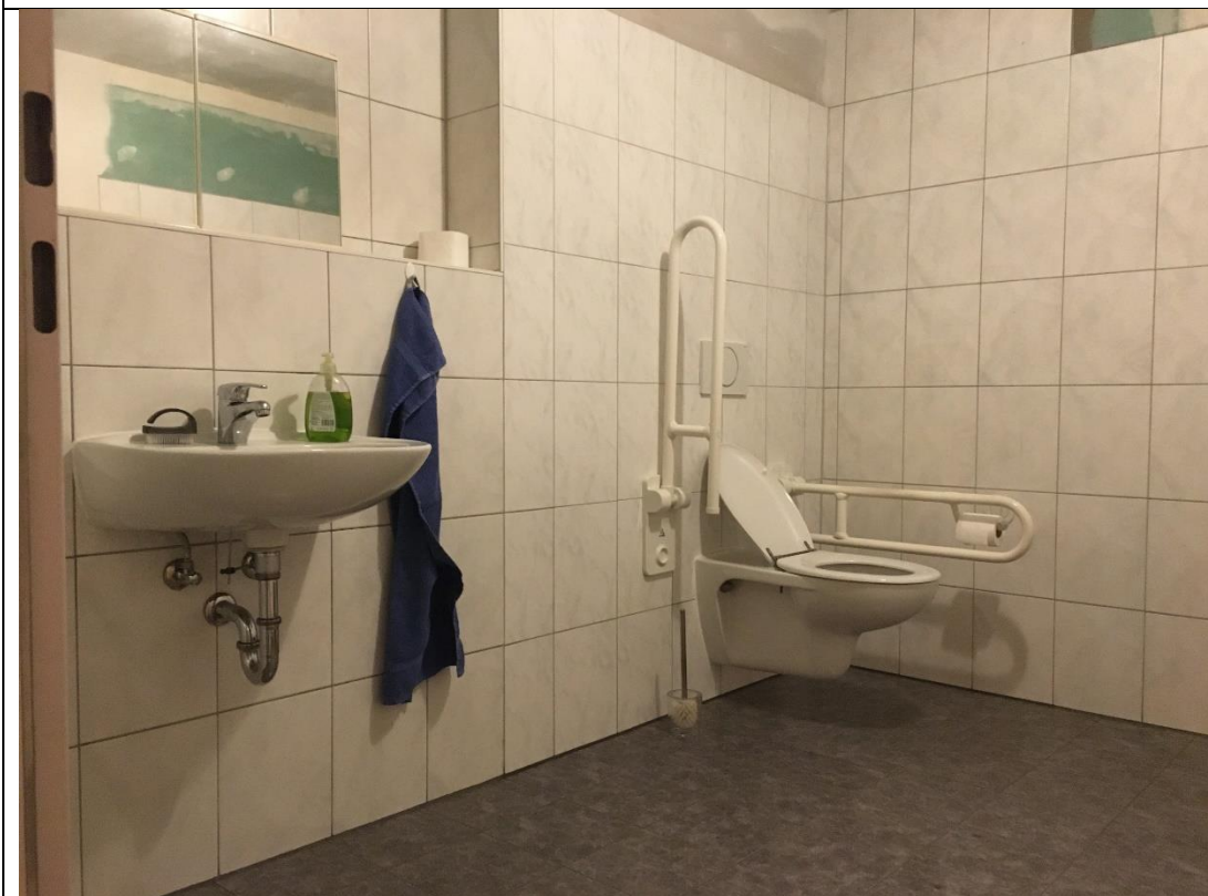
Gewerbehalle: Sanitäranlagen – Behindertengerechtes WC
