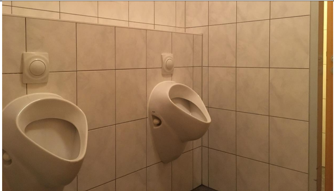
Gewerbehalle: Sanitäranlagen – Herren-WC
